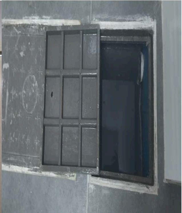
图 3-2 污水处理装置
